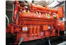
ガスエンジン発電機
